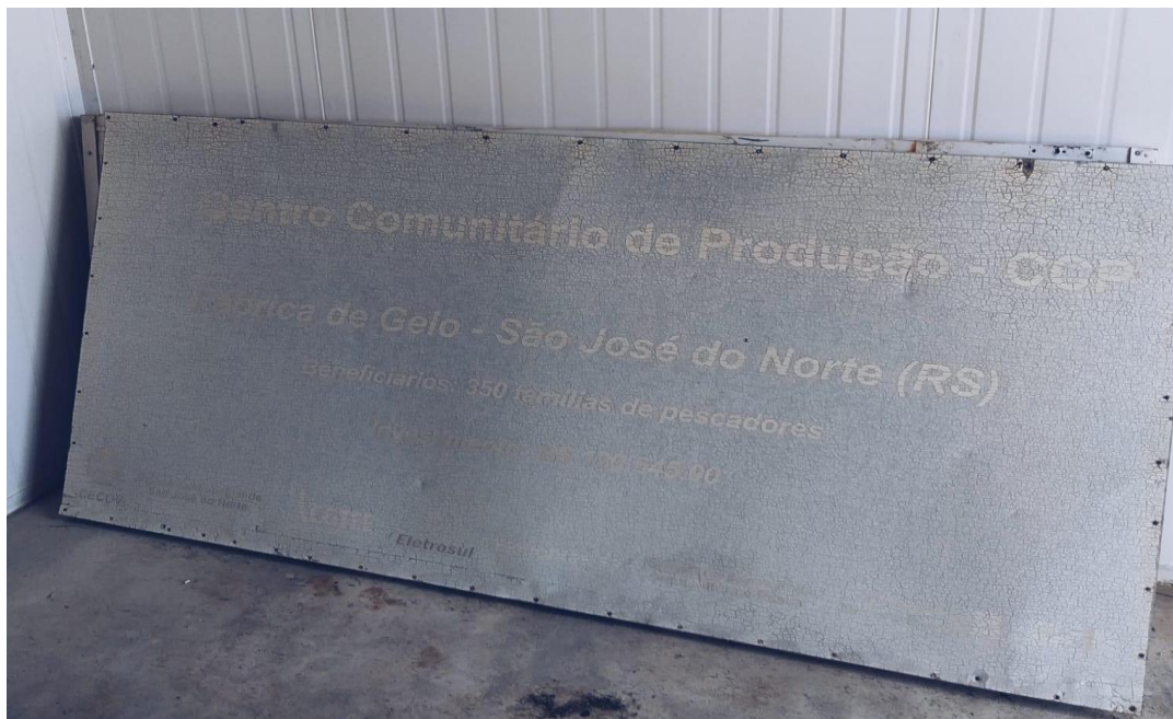
Figura 10 - Placa do CPP apagada na Fábrica de Gelo
